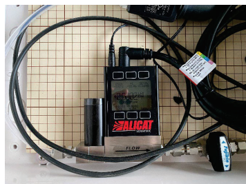
マスフローコントローラ（各室設置）
